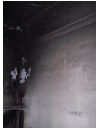
Slika 77: poškodbe po požaru-današnje stanje
